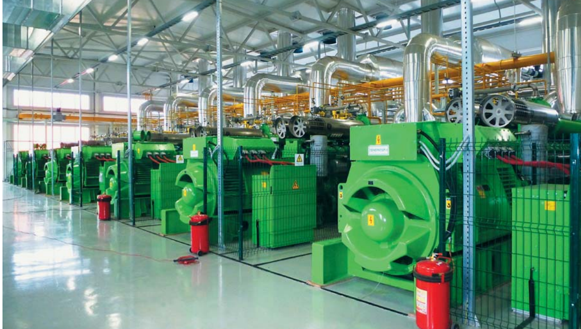
Энергоблоки JMS 620 производства GE Jenbacher
